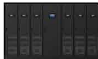
Bộ lưu điện UPS
